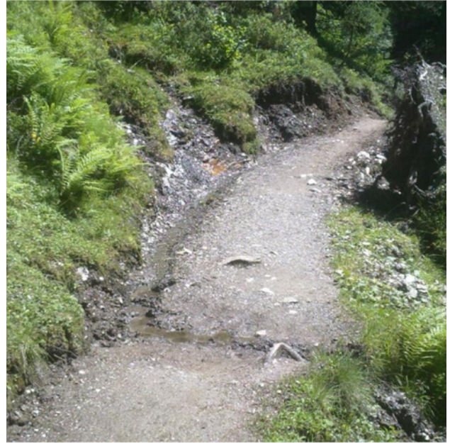
Abbildung 4: Hangwasseraustritt mit Entwässerungsrinne (Bild: Amor)
