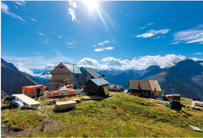
Die Ansbacher Hütte (2376 m) in den Lechtalern: Neben einem neuen Dach waren auch Brandschutzaufgaben umzusetzen.
